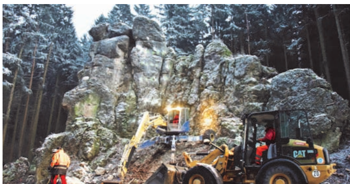
Der freigelegte Felsen vor der Sprengung - die zu bohrenden Sprenglöcher sind bereits markiert
