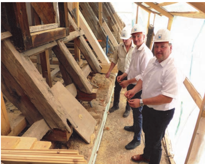
Balkenbröselwerk, die maroden Balken müssen alle ausgetauscht werden
